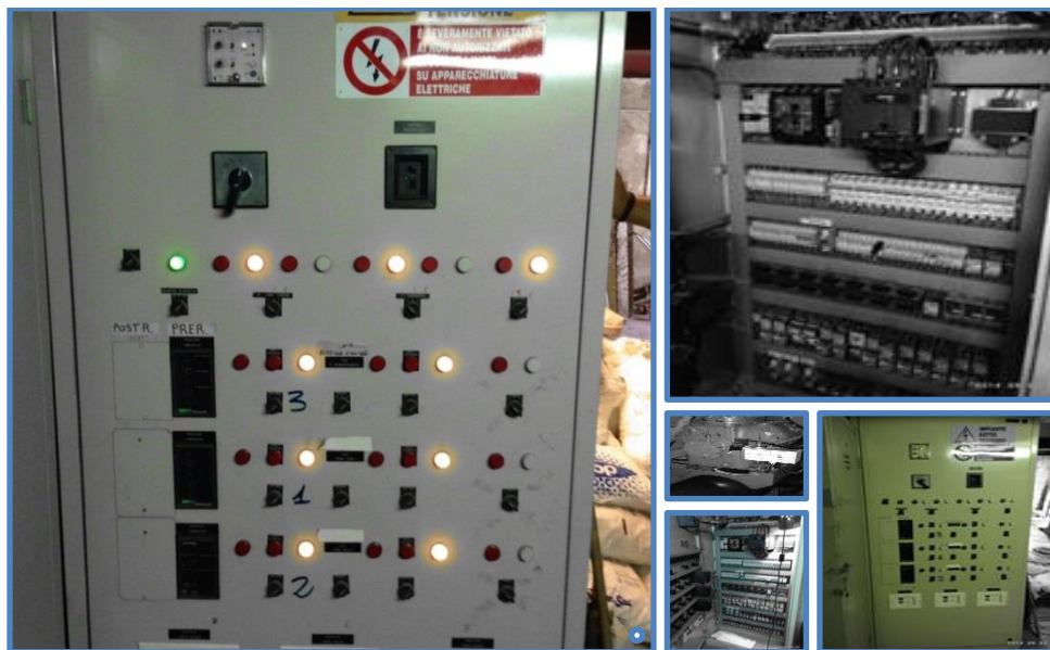
• QUADRI ELETTRICI CENTRALE TERMICA SALA PROVE BRA'
