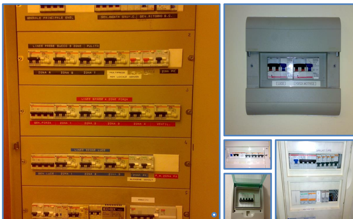
● Quadri Elettrici Uffici Amministrativi
