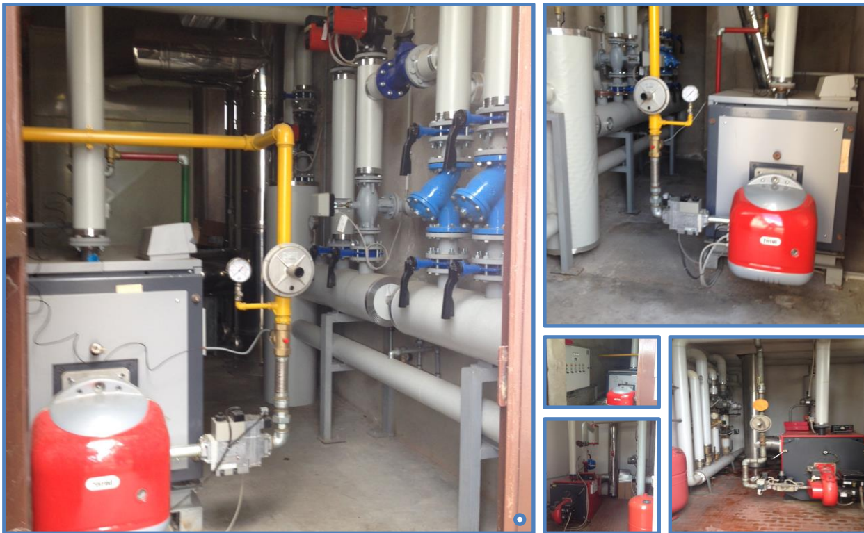
○ Centrali Termiche a servizio dei laboratori di scenografia
